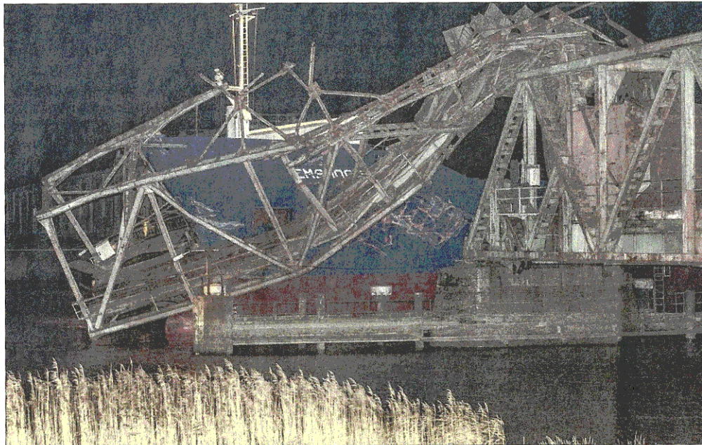
Der folgenschwere Unfall am Abend des 3. Dezember 2015: Der Frachter „Emsmoon“ kracht in das geschlossene Klappteil der Friesenbrücke in Weener. Foto: Archiv RZ
