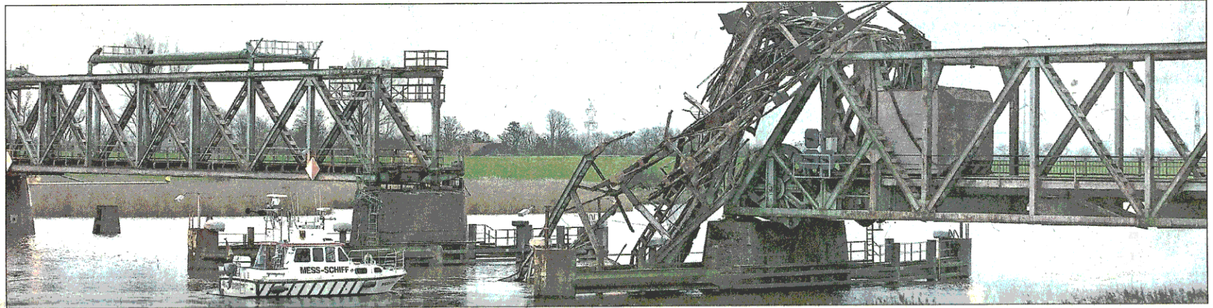
Dezember 2015: die völlig demolierte Friesenbrücke. Wann und wie der Wiederaufbau erfolgt, ist ungewiss.
