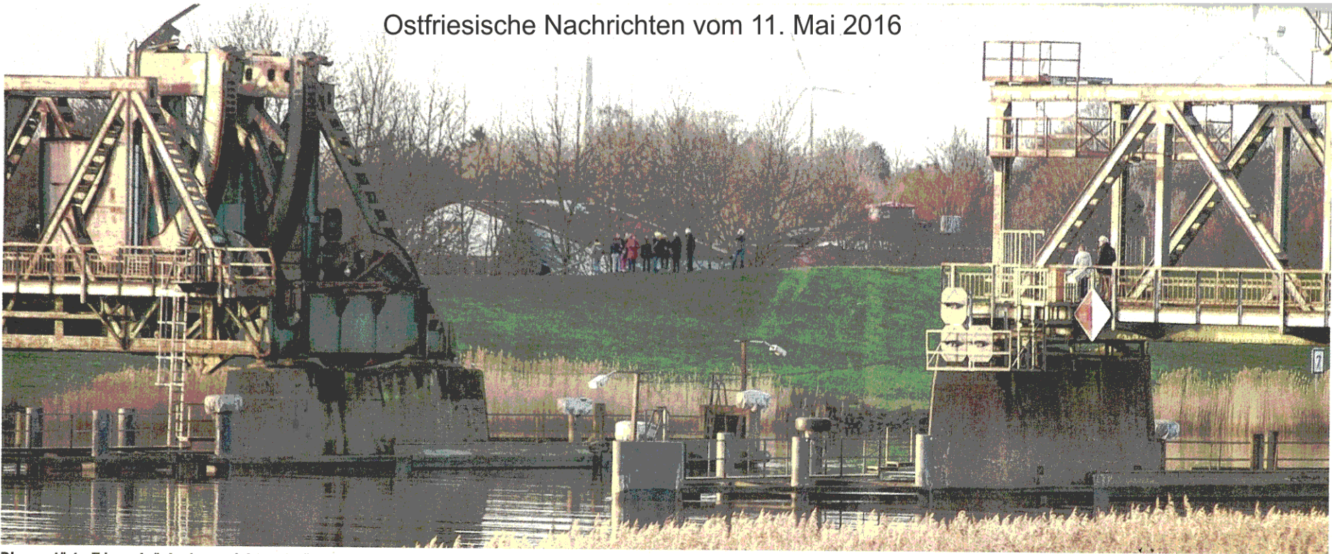
Die zerstörte Friesenbrücke kann nicht mehr überquert werden. Gestern gab es das erste Treffen der von der Deutschen Bahn eingerichteten Task Force.
