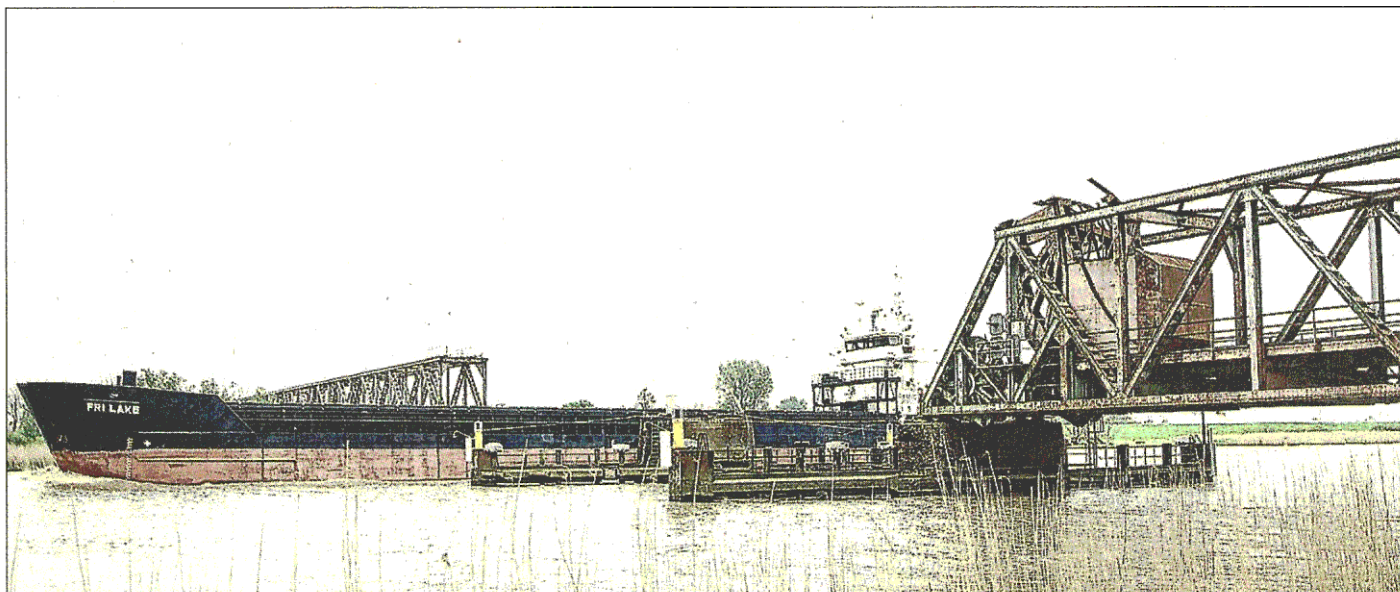
Ein Frachter fährt durch die Lücke in der Friesenbrücke. Wie ein Wiederaufbau des Bauwerks in der Ems bei Weener aussehen könnte, darüber will die Deutsche Bahn am 2. Juni die Öffentlichkeit informieren.
